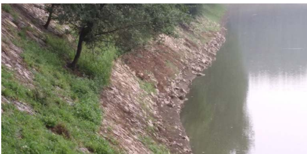
图 19 险工破损情况 3
