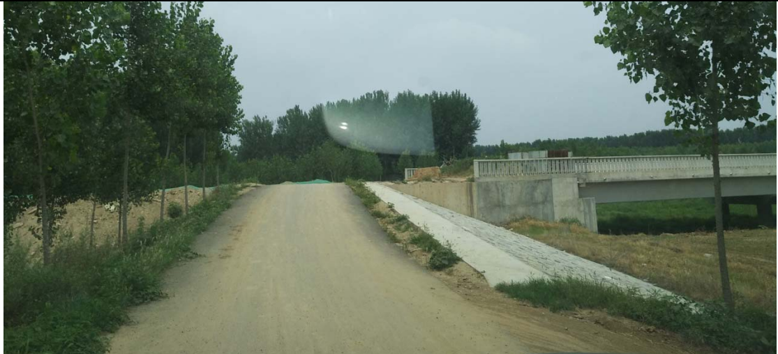
图 13 与在建侯谭线相交处沥青路面
