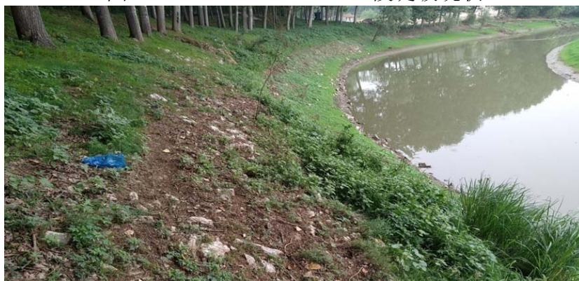
图 31 险工段堤坡现状
