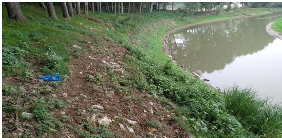
图 17 险工破损情况 1
