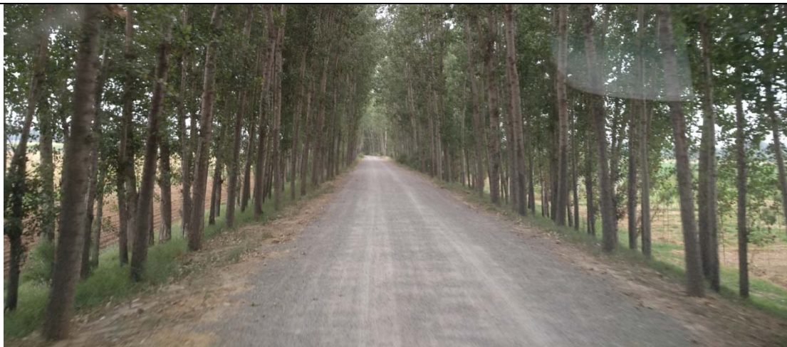
图 3 现状泥结石路面
