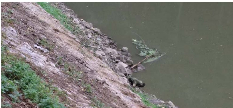
图 18 险工破损情况 2
